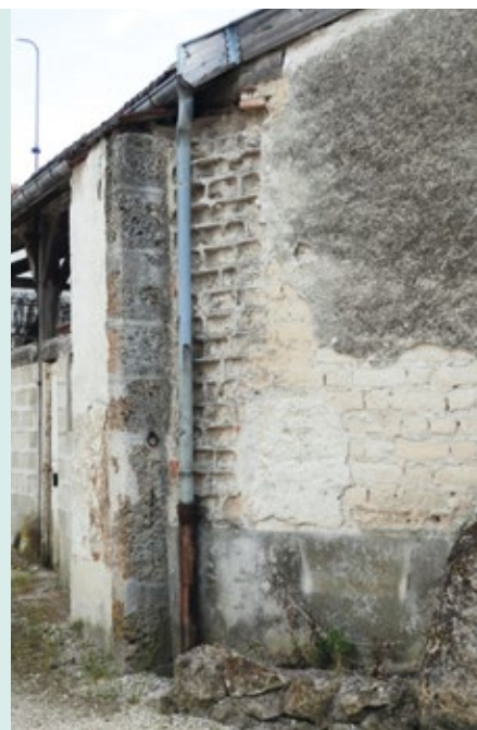
Bâtiment en carreaux de terre crue très dégradé, Bouzy
